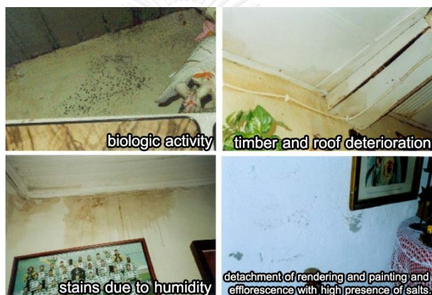
ภาพที่ 1.3 สภาพปัญหาที่พบบริเวณภายในอาคาร (Lourenco, Luso, & Almeida, 2006)
