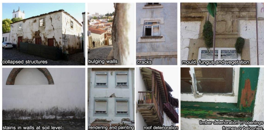
ภาพที่ 1.2 สภาพปัญหาที่พบบริเวณภายนอกอาคาร (Lourenco, Luso, & Almeida, 2006)
