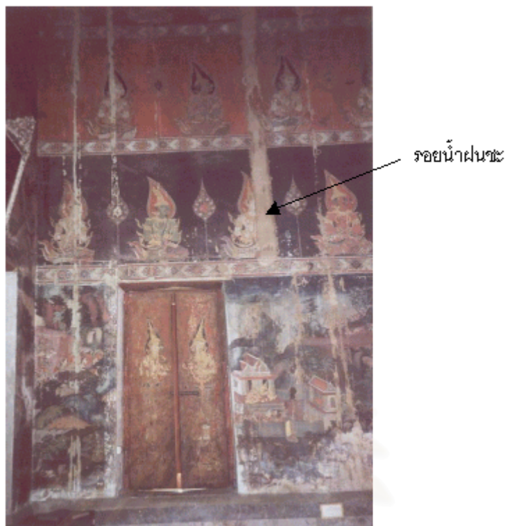
รูปที่ 2-2 รอยน้ำฝนรั่วจากหลังคา วัดสุวรรณารามราชวรวิหาร
