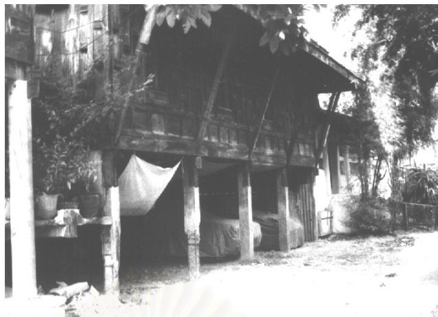
ภาพถ่าย 5.1.2 : เสาของกุฎิเดิมมีการเสื่อมสภาพบริเวณโคนเสาเหนือดินมาก จนทำให้มีการเปลี่ยนฐานรากและต่อม่อเป็น ค.ส.ล. (จากการสำรวจของผู้วิจัย ตุลาคม 2543)
