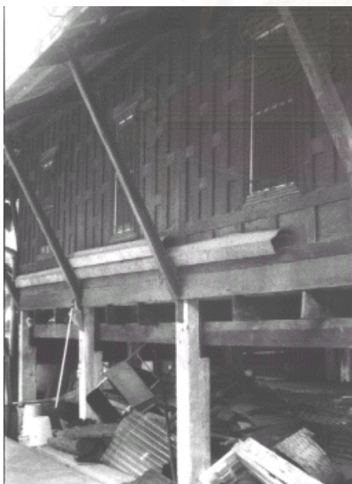
ภาพถ่าย 4.2.11 : สภาพส่วนตัวอาคาร ฝายังมีความเสียหายเล็กน้อย มีการติดตั้งเหล็กดัดและมุ้งลวด (จากการสำรวจของผู้วิจัย กันยายน 2543)
