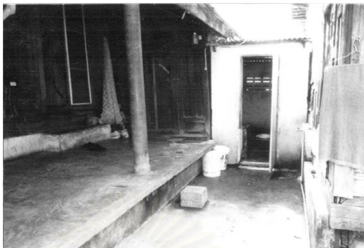
ภาพถ่าย 5.1.6 : การต่อเติมห้องน้ำอยู่ระหว่างกุฏิ ทำให้ฝาบริเวณดังกล่าวมีการเสื่อมสภาพมากกว่าส่วนอื่น (จากการสำรวจของผู้วิจัย ตุลาคม 2543)
