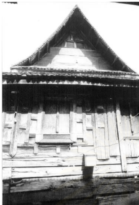
ภาพถ่าย 5.1.4 : ฝาบริเวณชายด้านล่างมีการเสื่อมสภาพมาก และมีการเดินสายไฟห้อยไปตามฝาปฏิบัติ (จากการสำรวจของผู้วิจัย ตุลาคม 2543)
