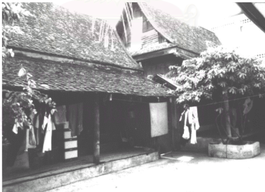
ภาพถ่าย 4.3.13 : สภาพส่วนหลังคา กระเบื้องมีการเสื่อมสภาพมากจนไม่สามารถใช้งานได้แล้ว แผงจั่วมีความเสียหายมาก มีการใช้สังกะสีตีปิดชั่วคราว (จากการสำรวจของผู้วิจัย ตุลาคม 2543)
