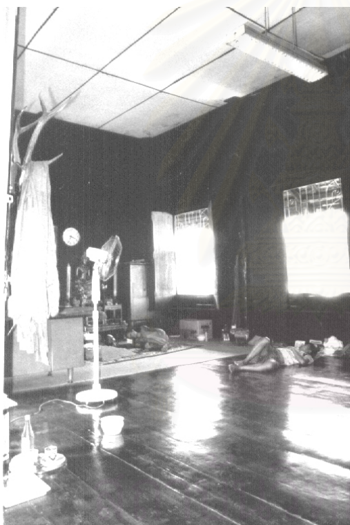
ภาพถ่าย 5.1.8 : การต่อเติมฝ้าเพดานโดยใช้ยิปซัมบอร์ด (จากการสำรวจของผู้วิจัย ตุลาคม 2543)
