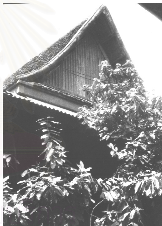
ภาพถ่าย 5.1.9 : ส่วนแฉ่งจั่วมีการเสื่อมสภาพมาก มีการใช้สังกะสีตีปิดไว้ชั่วคราว (จากการสำรวจของผู้วิจัย ตุลาคม 2543)
