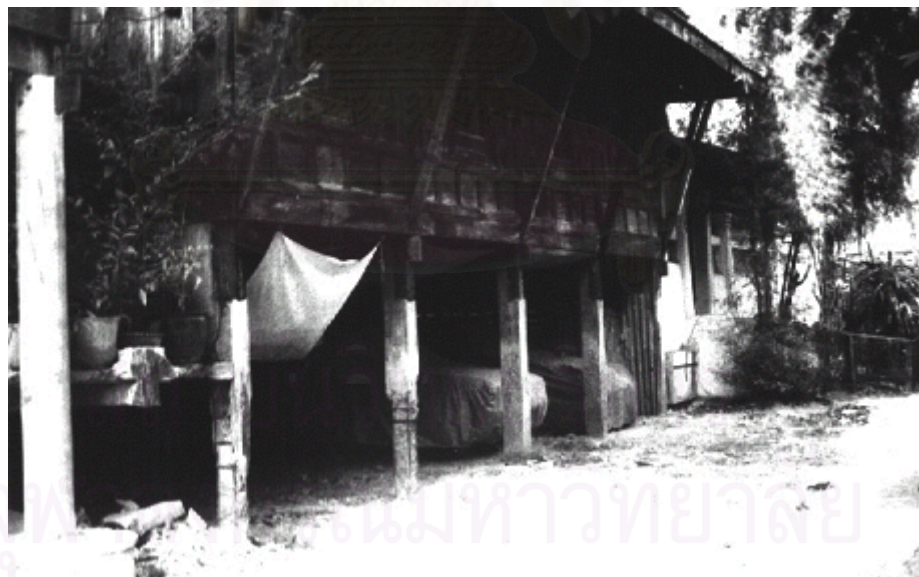
ภาพถ่าย 4.3.10: สภาพส่วนฐานอาคารมีการเปลี่ยนเสาบริเวณใต้ถุนเป็นเสา ค.ส.ล. ปัจจุบันเสา ค.ส.ล.มีการเสื่อมสภาพแล้ว (จากการสำรวจของผู้วิจัย ตุลาคม 2543)
