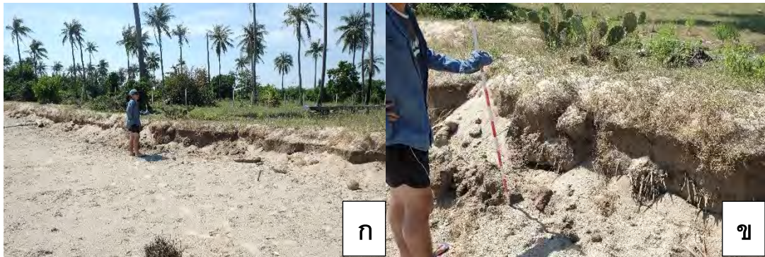
รูปที่ 4.42 ร่องรอยการกัดเซาะบริเวณชายฝั่งทะเลด้านข้างบริเวณการสร้างกำแพงกันคลื่น
