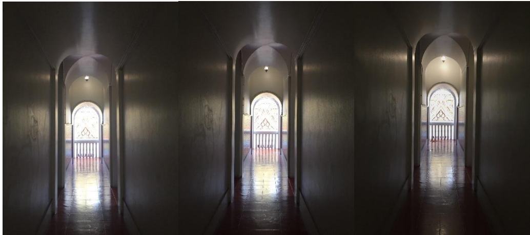
ภาพ(ผนวก ข)ที่ 4 ภาพบริเวณโถงทางเดินชั้น 3
