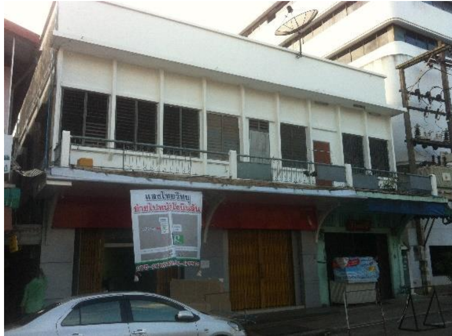
ภาพที่ 69 การรื้อโครงสร้างภายนอกที่ต่อเติมตึกแถวออกเพื่อให้กลับสู่รูปแบบเดิม
