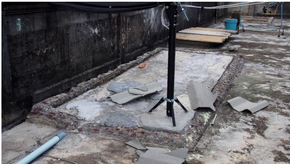
ภาพที่ 90 บ่อน้ำคอนกรีตเก่าชั้นดาดฟ้าของโรงแรมจริงจริง มีปัญหาเรื่องการรั่วซึม
