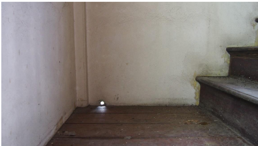
ภาพที่ 98 จุดเสื่อมสภาพของอาคาร เนื่องจากน้ำที่รั่วไหลจากเพดาน
