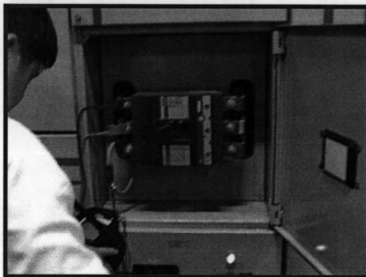
รูปที่ 3.19 แสดงการวัดค่าพลังงานไฟฟ้าที่ตู้ไฟฟ้า
