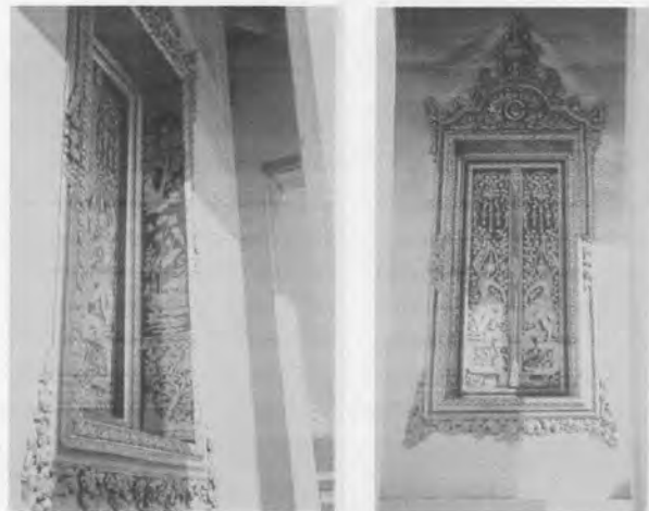
ภาพที่ 2.7 - 2.8 รายละเอียดซุ้มหน้าต่าง บานภายนอก ทับหลัง และผนังกบ
