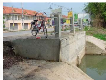
รูปที่ 3.5 อาคารควบคุมระบายน้ำเสีย
