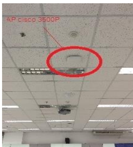
รูปที่ 3.16: ตำแหน่งติดตั้งจุดเข้าถึงไร้สายของชั้น 4 และ 5 มีการติดตั้งติดกับเพดานที่สูงจากพื้น 3.3 เมตร ในอาคารวิศวะฯ 100 ปี
