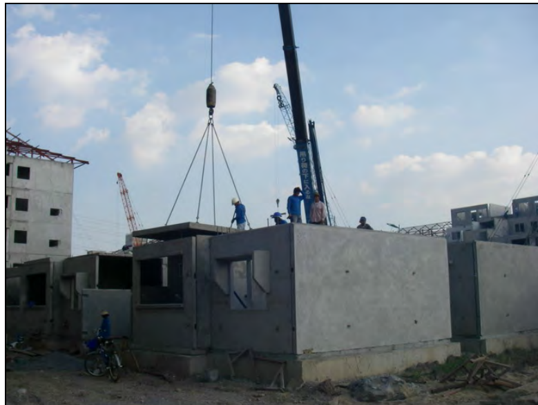
รูปที่ 4.30 การยกแผ่นพื้นสำเร็จรูปเพื่อทำการติดตั้ง
