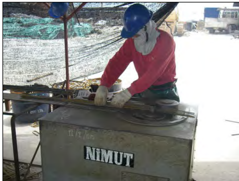
รูปที่ 4.6 การตัดเหล็กเสริมให้ได้รูปร่างและขนาดตามที่กำหนด
