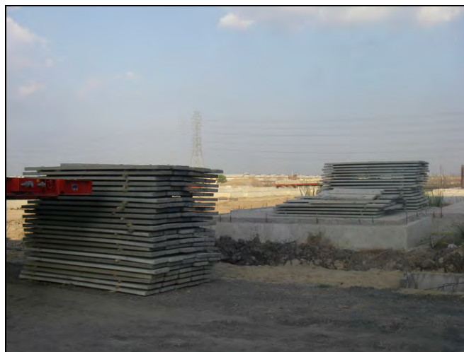
รูปที่ 4.22 การจัดเก็บแผ่นพื้นคอนกรีตสำเร็จรูปภายในหน่วยงานติดตั้งชิ้นงาน
