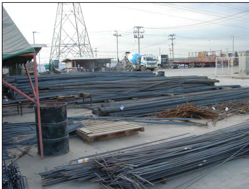
รูปที่ 4.4 การกองเก็บเหล็กเสริมภายในพื้นที่คลังวัสดุ
