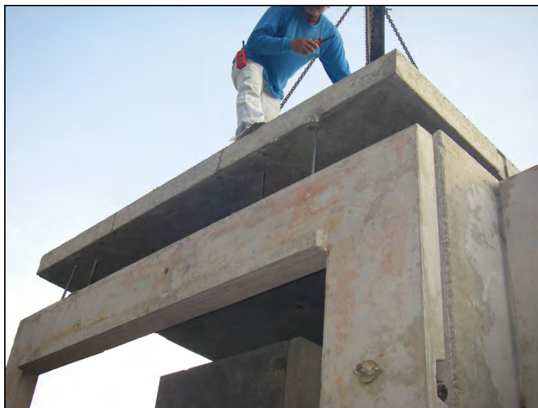
รูปที่ 4.31 การติดตั้งแผ่นพื้นโดยให้รอยต่อระหว่างแผ่นพื้นกับแผ่นผนังตรงกัน
