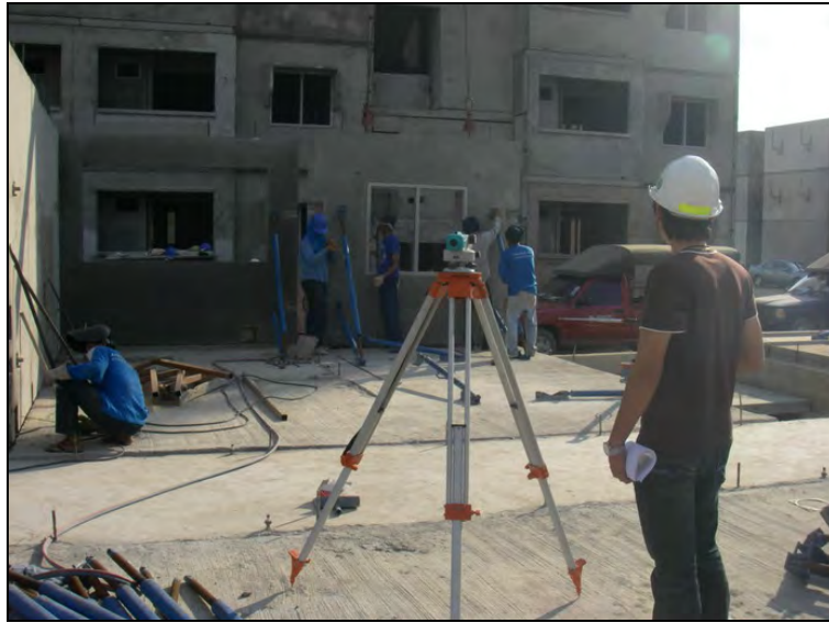
รูปที่ 4.26 การตรวจสอบระดับแนวราบของการติดตั้งแผ่นผนัง
