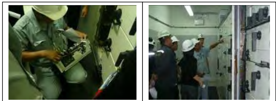
รูปที่ 6.6 การทำ PM ตรวจเช็คสถานะห้อง MCC ภาคปฏิบัติการ
