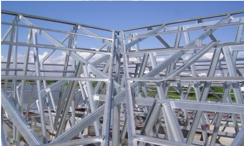
ภาพ 3.31 การติดตั้งสันหลังคาและจันทันเหล็กชุบกัลวาไนซ์
