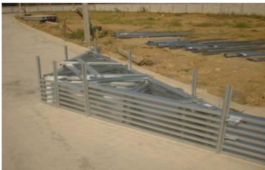
ภาพ 4.19 การประกอบโครงถักเหล็กชุบสังกะสีบริเวณถนนของพื้นที่ก่อสร้าง ที่มา : ถ่ายโดยผู้วิจัย วันที่ 5 มกราคม 2561
