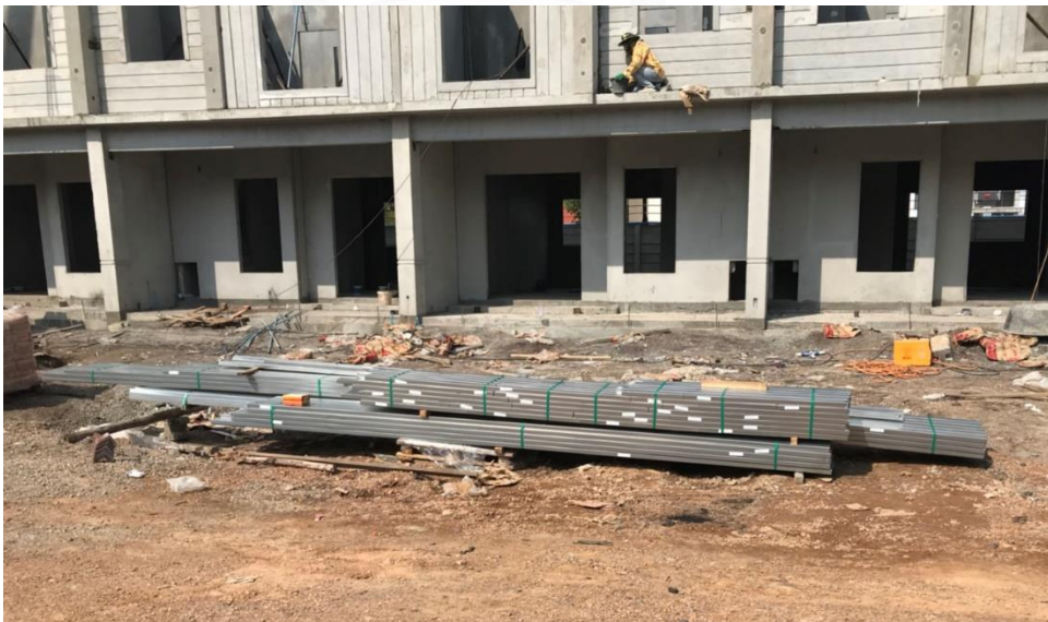
ภาพ 3.25 ชิ้นส่วนเหล็กชุบสังกะสีกองเก็บบริเวณพื้นที่ก่อสร้าง
