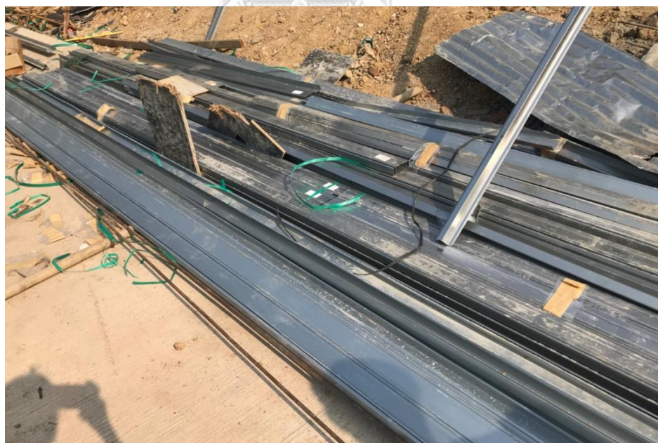
ภาพ 4.18 ความสกปรกที่เกิดขึ้นกับชิ้นส่วนเหล็กชุบสังกะสีขณะกองเก็บบริเวณสถานที่ก่อสร้าง ที่มา : ถ่ายโดยผู้วิจัย วันที่ 5 มกราคม 2561
