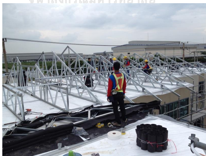
ภาพ 5.54 นำโครงถักสำเร็จรูปมาติดตั้งที่สถานที่ก่อสร้างเป็นรูปแบบโครงถักเดิมที่ใช้อยู่ในปัจจุบัน ที่มา : บริษัท ปูนซิเมนต์ไทย จำกัด (มหาชน)
