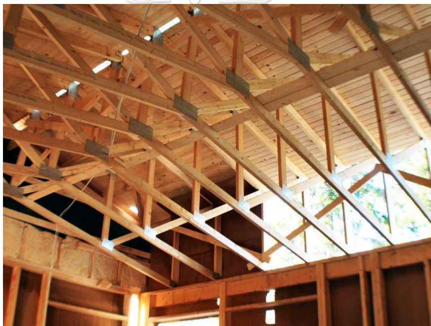
ภาพ 6.1 แสดงโครงหลังคาไม้
