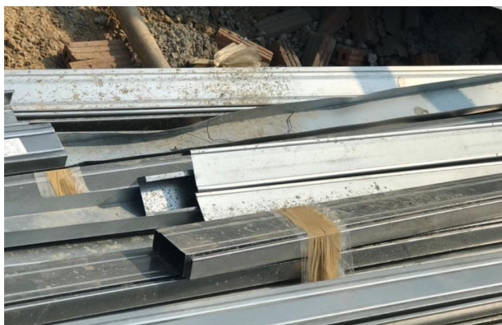
ภาพ 4.16 ความเสียหายของชิ้นส่วนเหล็กชูปักลวดไนซ์ขณะกองเก็บบริเวณสถานที่ก่อสร้าง
