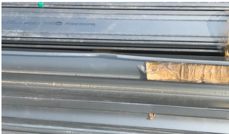
ภาพ 4.17 ความเสียหายของชิ้นส่วนเหล็กชุบสังกะสีขณะกองเก็บบริเวณสถานที่ก่อสร้าง ที่มา : ถ่ายโดยผู้วิจัย วันที่ 5 มกราคม 2561
