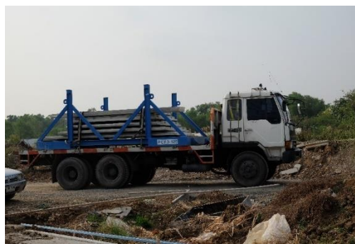
ภาพที่ 30 การขนส่งชิ้นส่วนพื้นคอนกรีตสำเร็จรูป
