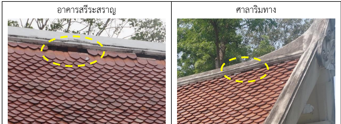
ภาพที่ 119 แสดงตัวอย่างกระเบื้องหลังคาหลุด แนวสันหลังคา
