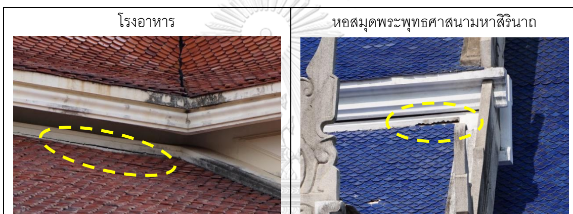
ภาพที่ 116 แสดงตัวอย่างปัญหาจากกรอบปิดรอยต่อปีกนกกับผนังอาคารหรือหลังคาจั่วแตก
