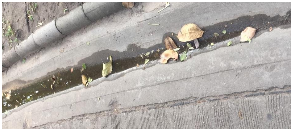
ภาพที่ 45 ทางระบายน้ำอุดตันเนื่องจากดินที่ไหลมากองรวมกัน
