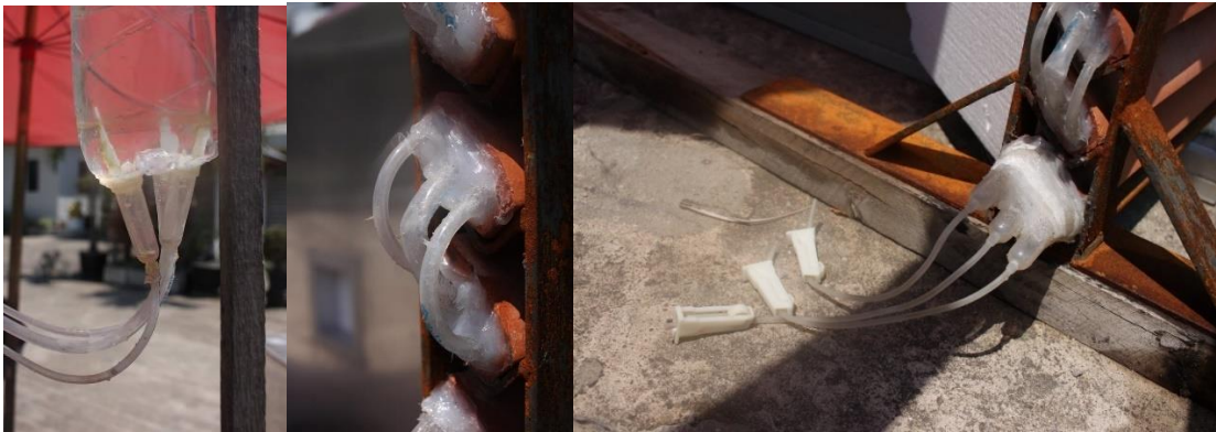
ภาพที่ 3.7 การติดตั้งสายยางในระบบ และ ตัวควบคุมการไหลของน้ำในระบบที่ปลายของแผงกันแดดพร้อมยาแนวด้วยกาวยางซิลิโคนเพื่อป้องกันการรั่วซึม
