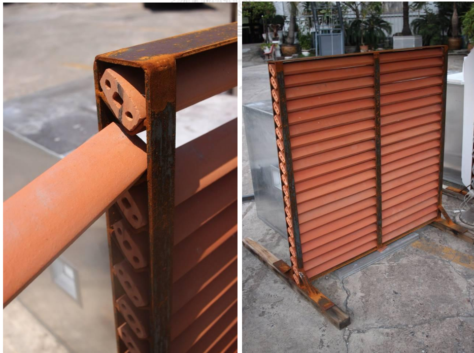
ภาพที่ 3.5 การติดตั้งแผงกันแดดเข้ากับโครงเหล็กที่ทำเตรียมไว้
