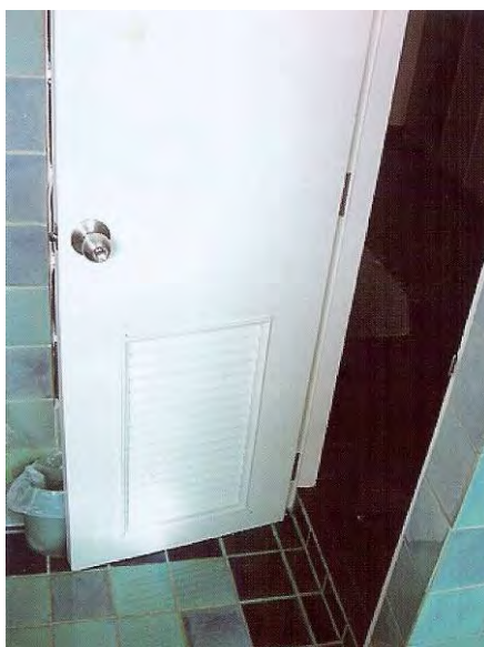
ภาพที่ 2.14 แสดงประตูห้องน้ำที่เป็นบานเกล็ดทำให้แอร์รั่ว นำกลิ่นและความชื้นจากห้องน้ำเข้ามาในห้องพักอาศัย
