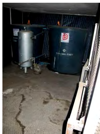
ภาพที่ 4.27 แสดงการสำรองน้ำใช้บนดาดฟ้าอาคาร ตามการคำนวณจำนวนผู้ใช้อาคาร
