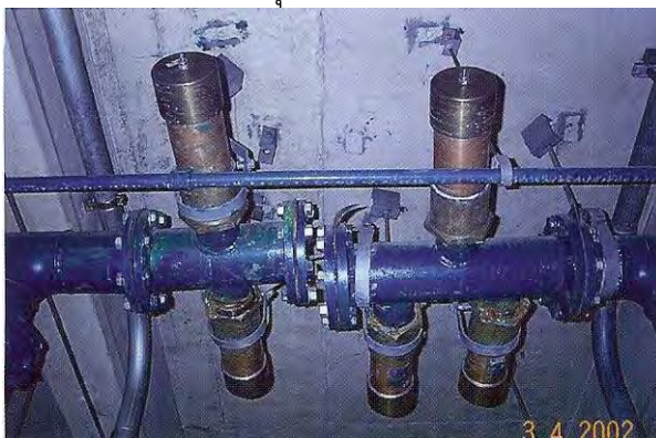
ภาพที่ 2.10 แสดงตัวอย่างการติดตั้งอุปกรณ์ป้องกันน้ำกระแทกเหนือฝ้าเพดานห้องน้ำ
