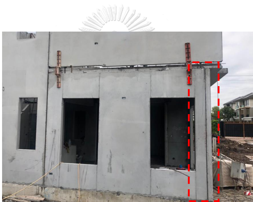
ภาพที่ 40 ตัวอย่างชั้นส่วนผนังที่มีระยระริมช่องเปิดน้อยในระหว่างการติดตั้ง
