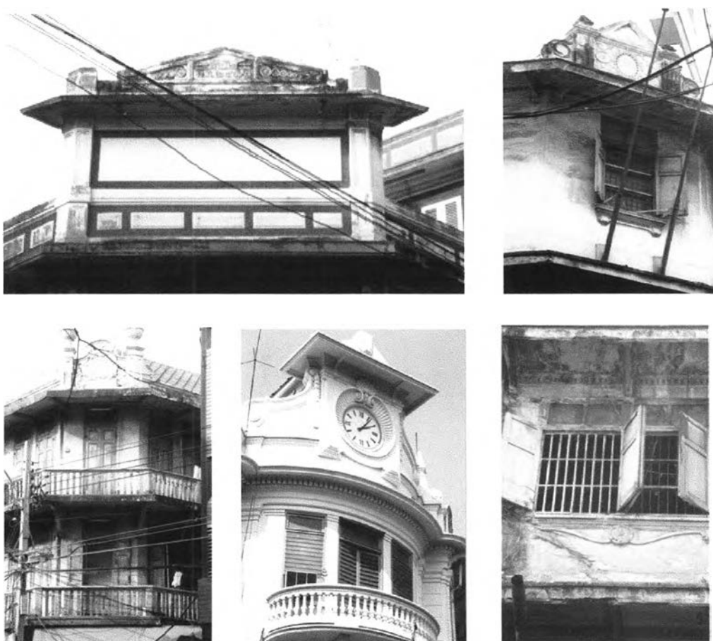
ภาพที่ 179 คุณค่าด้านสุนทรียภาพทางสถาปัตยกรรมและศิลปกรรมของชุดตึกแถวริมถนนเจริญกรุงที่สร้างขึ้นในสมัยรัชกาลที่ 4 ถึงรัชกาลที่ 7 ซึ่งพิจารณาจากความพิถีพิถันในการสร้าง โดยมีการประดับตกแต่งด้วยลวดลายปูนปั้น โดยเฉพาะในส่วนที่เป็นยอดของตึกแถวชุดหัวมุม และรอบประตูหน้าต่าง
