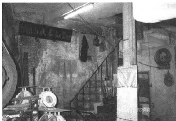
ภาพที่ 172 ปัญหาทางสถาปัตยกรรมที่เกิดจากการชำรุดของส่วนประกอบของตึกแถวริมถนนเจริญกรุง ดังเช่น หลังคาแบบแบนราบ วัสดุคอนกรีตเสริมเหล็ก
