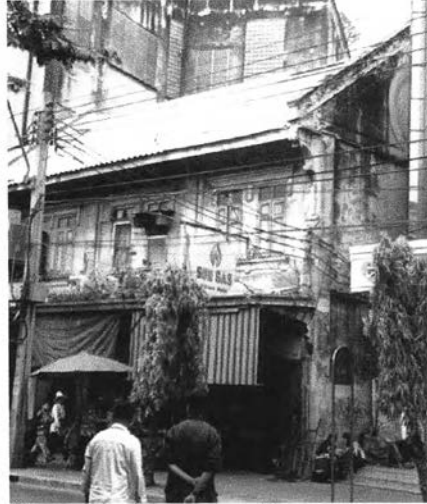
ภาพที่ 169 ปัญหาความชื้นของผนังที่ทำให้ราและไลเคนแพร่พันธุ์ จนเป็นคราบดำบนผนัง
