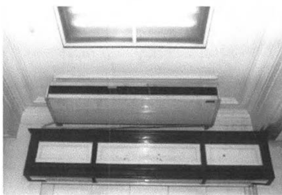
ภาพที่ 177 ปัญหาการเพิ่มและการติดตั้งระบบวิศวกรรมสมัยใหม่ของตึกแถว
