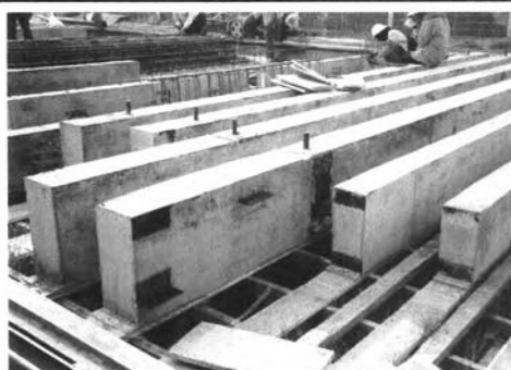
ภาพที่ 5-137 ทุกชิ้นงานผ่านการตรวจสอบให้ได้มาตรฐานก่อนการติดตั้ง
