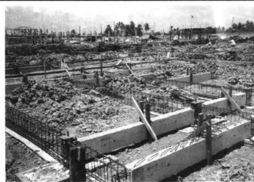
ภาพที่ 5-99 ติดตั้งโครงเหล็กเหล็กคานคอดินเมน
