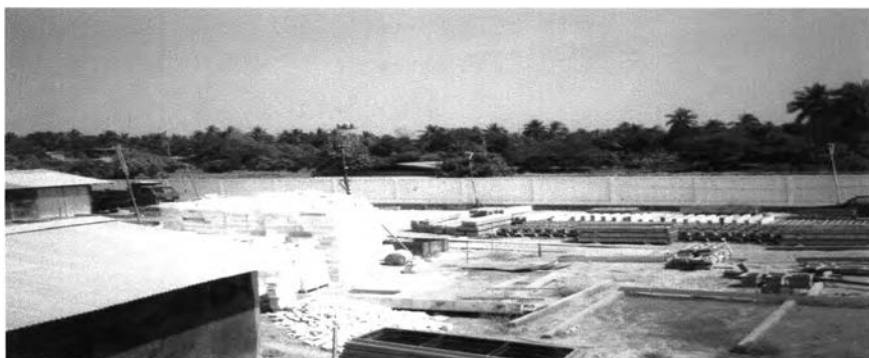
ภาพที่ 5 – 14 โรงเก็บวัสดุและพื้นที่กองเก็บวัสดุในการผลิตชิ้นส่วนสำเร็จรูป
