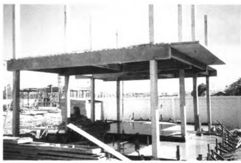
ภาพที่ 5 - 122 เทคอนกรีตพื้นชั้นล่างแล้วเสร็จ
