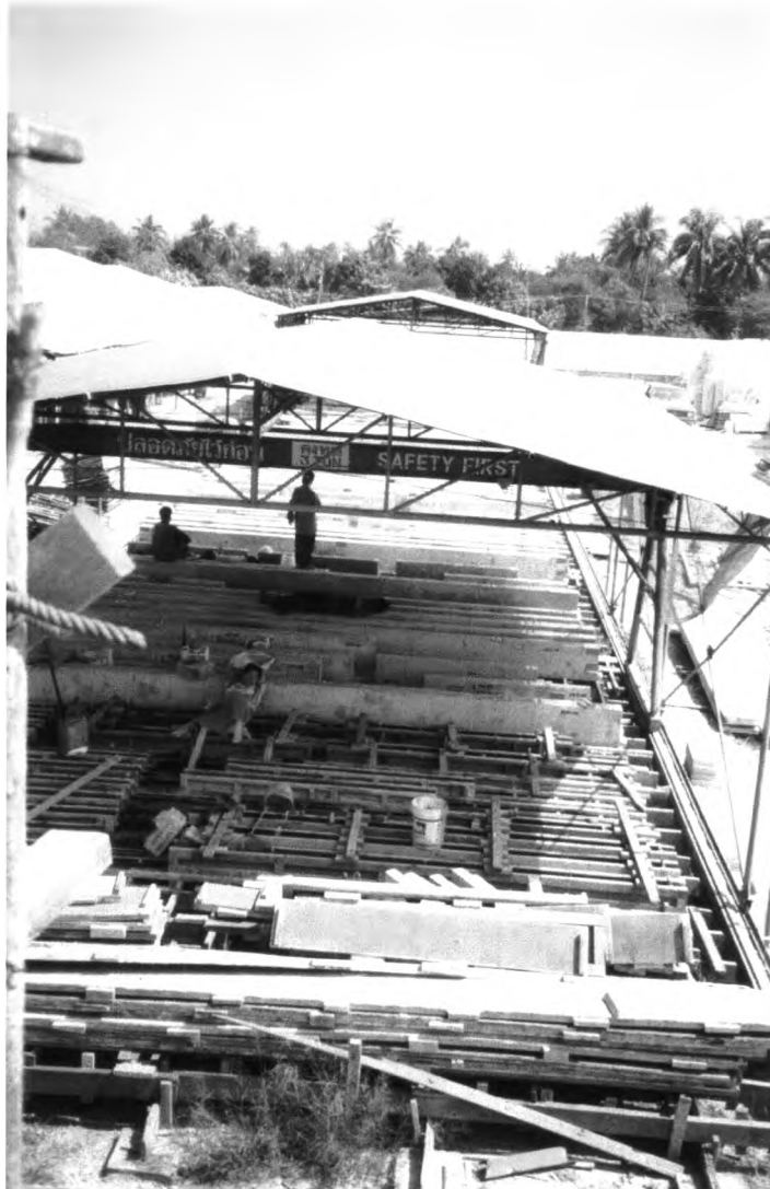
ภาพที่ 5-10 โรงงานส่วนผลิตชิ้นส่วนคานสำเร็จรูป ด้านหลัง
