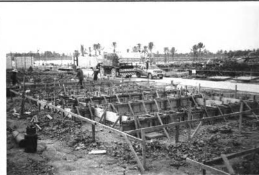
ภาพที่ 5-101 เทคอนกรีตหล่อชิ้นงานคานคอดิน
