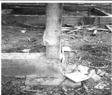
ภาพที่ 5- 140 ขนาดของเสาและคานไม่ได้ระดับเสมอกัน
