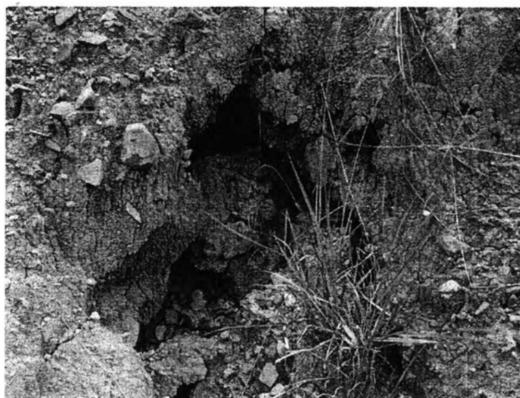
รูปที่ 2.3 การทรุดตัวของพื้นผิวดินอันเนื่องมาจากเกิดโพรงใต้คันทางรถไฟ
