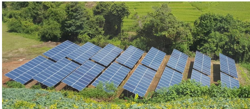
รูปที่ 5.5 ระบบผลิตไฟฟ้าจากพลังงานแสงอาทิตย์ของไมโครกริดบ้านขุนแปะ กำลังการผลิตติดตั้งขนาด 100 kW p
