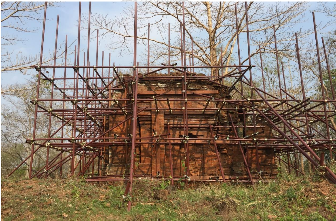
ภาพที่ 39 ปราสาทปลายบัด 2 ระหว่างดำเนินการบูรณะ ภาพถ่ายสำรวจ: เมื่อวันที่ 19 มีนาคม 2563
