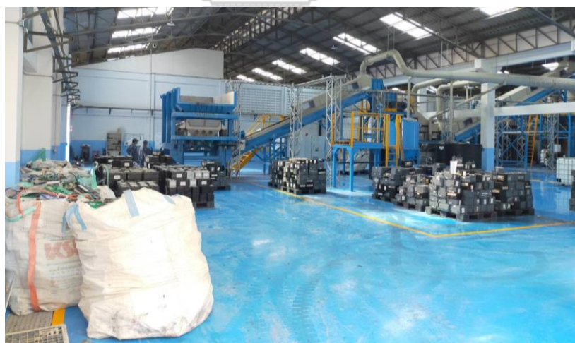
ภาพที่ 30 ติดตั้งรวบรวมฝุ่นตะกั่วและไอกรดไปบำบัดยังระบบบำบัดอากาศเสีย
