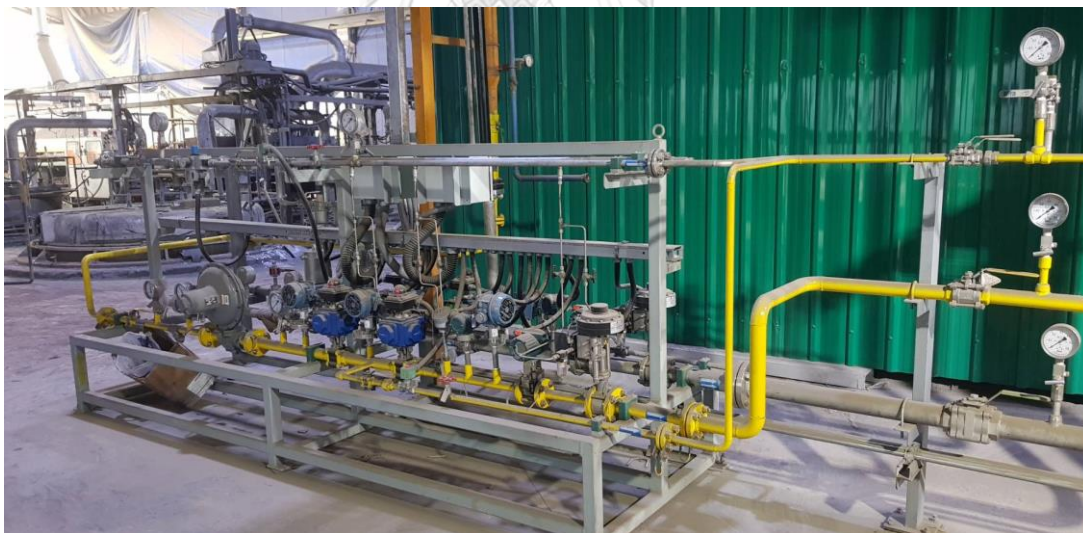
ภาพที่ 43 ชุดควบคุมหัว Burner และฉากกันป้องกันรังสีความร้อน
