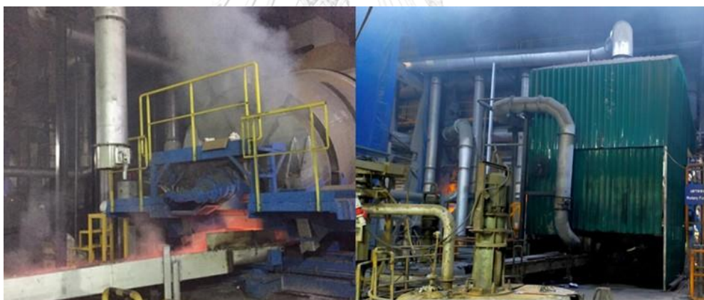
ภาพที่ 36 จัดทำฝาท่อ และฉากกั้นเพื่อป้องกันการฟุ้งกระจายของฝุ่นตะกั่ว
