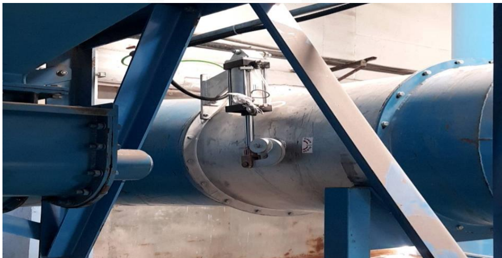
ภาพที่ 45 เปิด-ปิด Damper อัตโนมัติที่บริเวณ Dust filter
