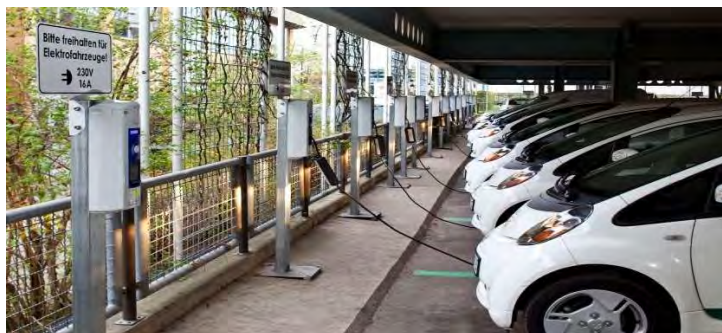
ภาพที่ 13 รูปแบบการติดตั้งเครื่องอัดประจุแบบ Fleet
