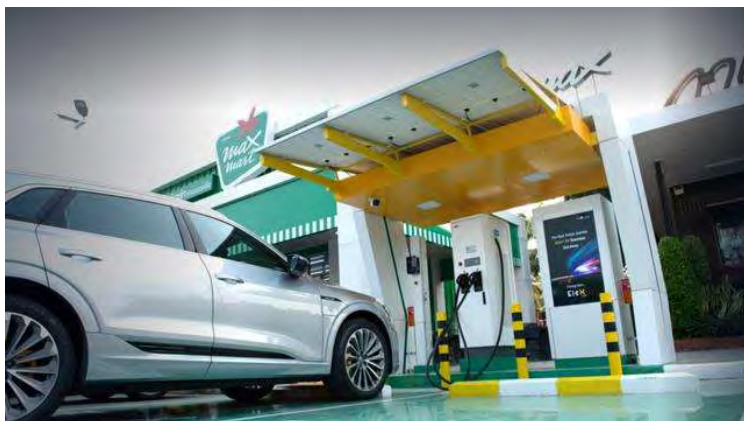
ภาพที่ 16 รูปแบบการติดตั้งเครื่องอัดประจุแบบ Quick Charge ในสถานีปั้มน้ำมัน
