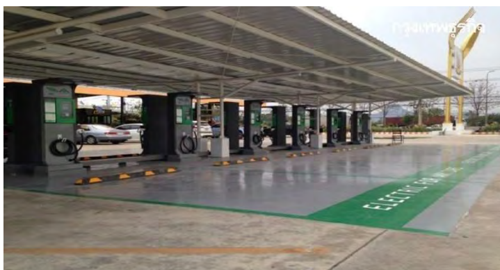
ภาพที่ 15 รูปแบบการติดตั้งเครื่องอัดประจุแบบลานจอดรถ
