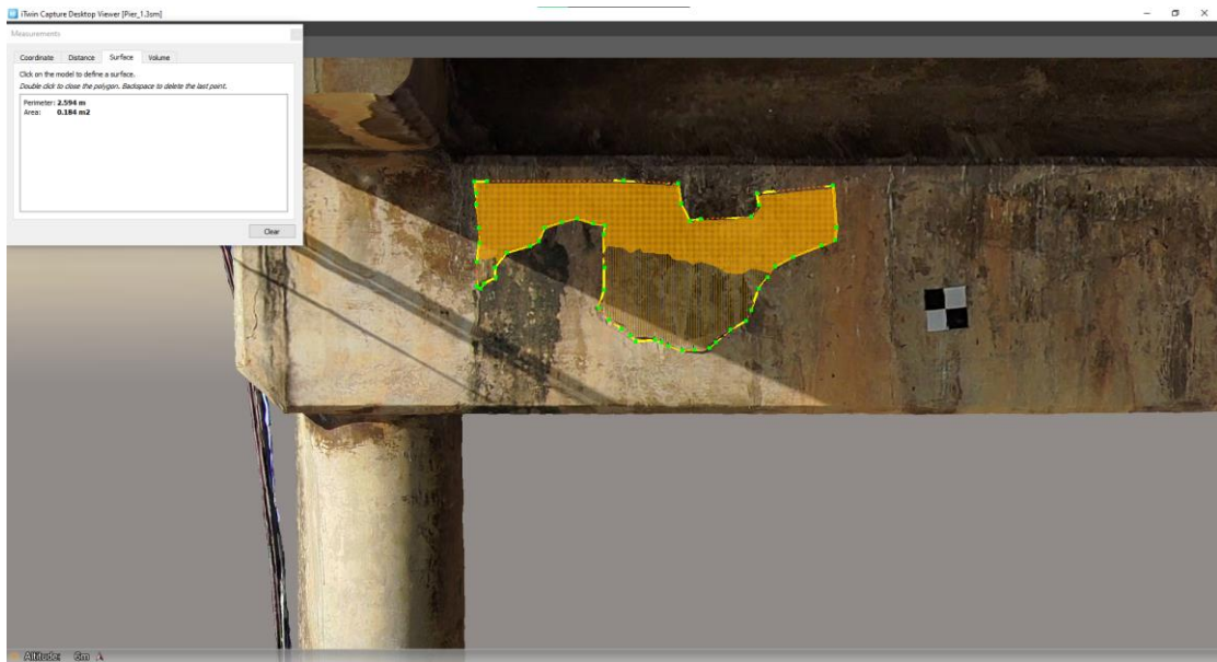
รูปที่ 32 การวัดขนาดพื้นที่การหลุดร่อนของชิ้นส่วนคานรัดหัวเสา
