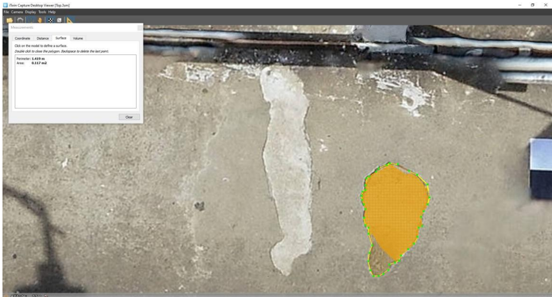
รูปที่ 30 การวัดขนาดพื้นที่การหลุดร่อนของคอนกรีตบนทางเท้า
