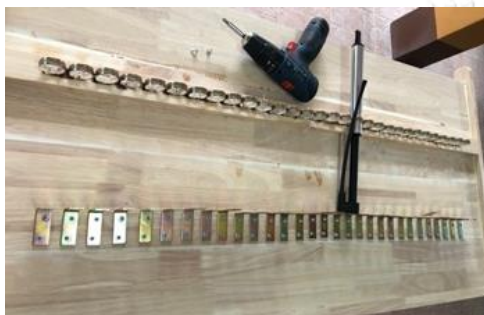
ภาพที่ 189 ตัวเรือนที่ติดตั้งเหล็กฉากแล้ว ที่มา : ผู้วิจัย
