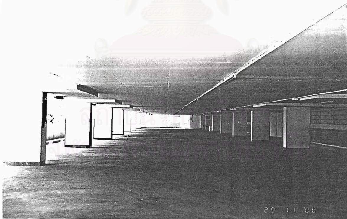
รูปที่ 3.33 : สภาพที่จอดรถภายในอาคารที่จอดรถของโครงการฯ ที่ชั้นบนยังไม่ค่อยมีผู้พักอาศัย นำรถมาจอด อาจเนื่องจากโครงการฯ ยังมีผู้พักอาศัยน้อย ( ในภาพที่แสดง ชั้น 3 A )
