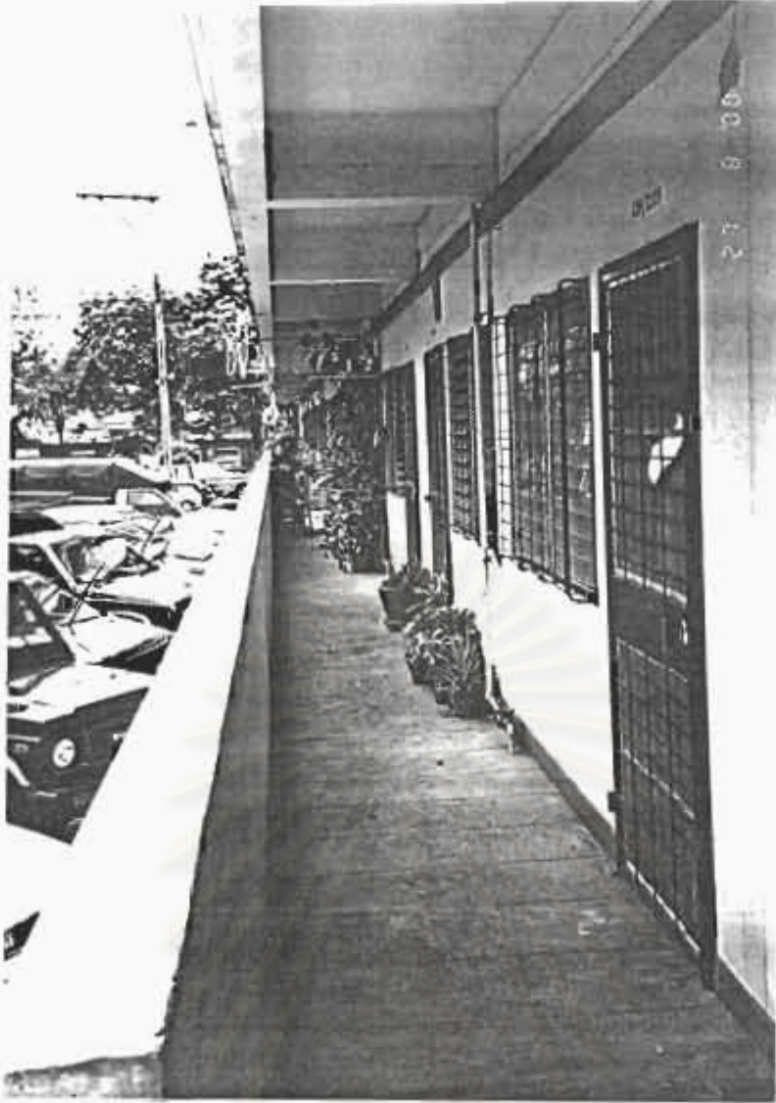
รูปที่ 3.15 : สภาพทางเดินหน้าห้องพักในปัจจุบันของโครงการเคหะชุมชนทุ่งสองห้อง
