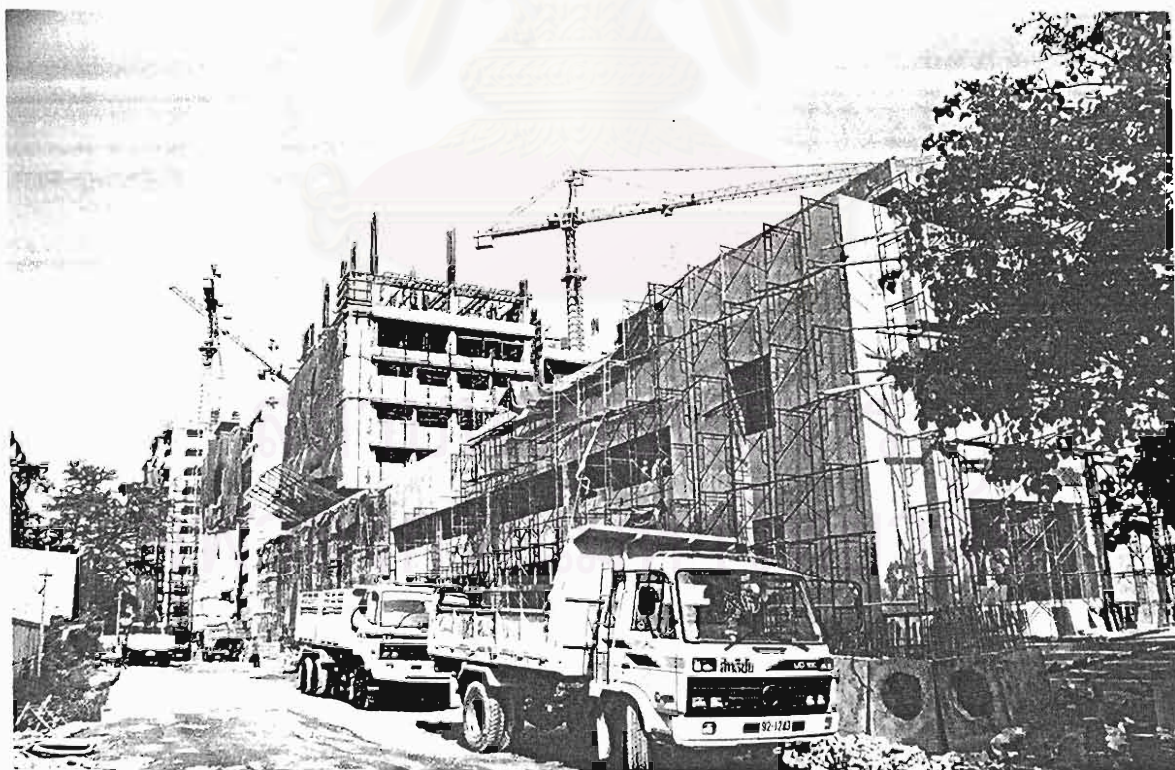
รูปที่ 3.22 : แสดงสภาพอาคารขณะกำลังดำเนินการก่อสร้างทางด้านข้างอาคาร , ทางเข้าโครงการ
