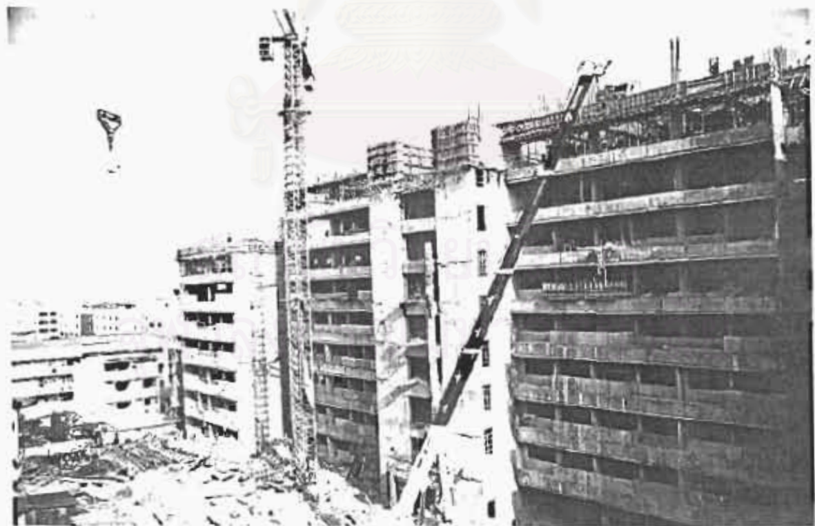
รูปที่ 3.24 : แสดงสภาพอาคารขณะกำลังดำเนินการก่อสร้างภายในโครงการ
