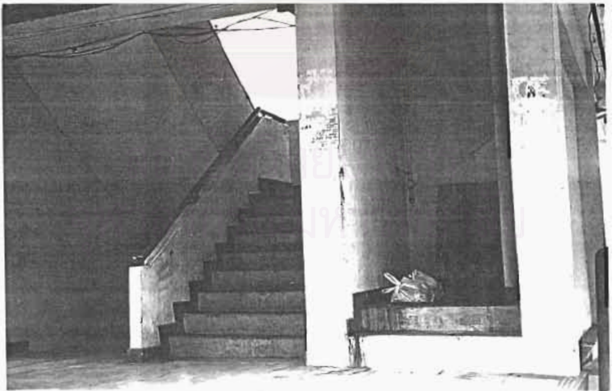
รูปที่ 3.16 : บริเวณบันไดและที่ทิ้งขยะของโครงการเคหะชุมชนทุ่งสองห้อง
