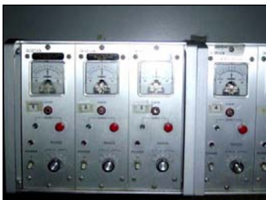
ก) อุปกรณ์รับสัญญาณอนาล็อกเครื่องวัดระดับน้ำ
