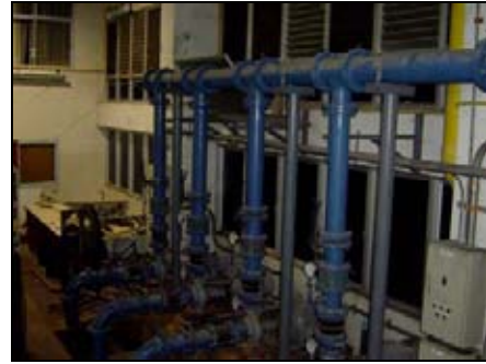
ข) ระบบท่อจากถังเก็บน้ำ
