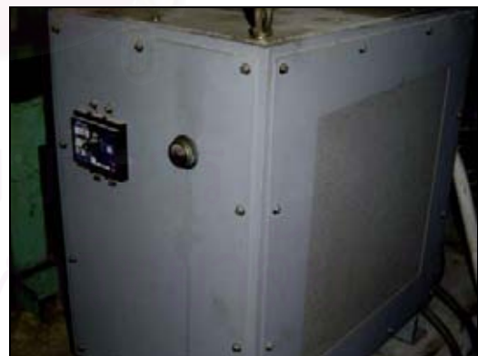
หม้อแปลงกระแสไฟฟ้า
