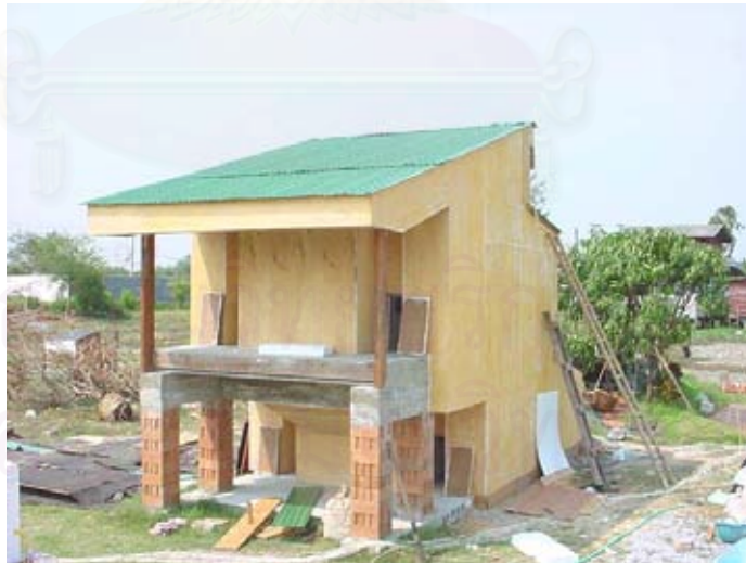
ภาพที่ 3.1 หุ่นจำลองอาคารกรณีศึกษา สัดส่วน 1:3 ที่ตั้ง ตำบลดอกไม้ เขตประเวศ กรุงเทพมหานคร
