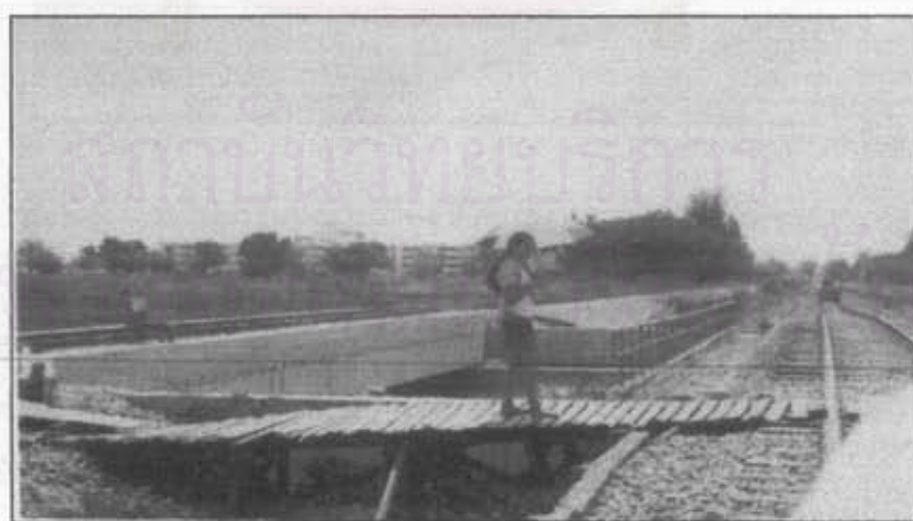
รูปที่ 5-3 สภาพรางรถไฟสายตะวันออกที่ไม่มีกั้นเขตทางชัดเจน
