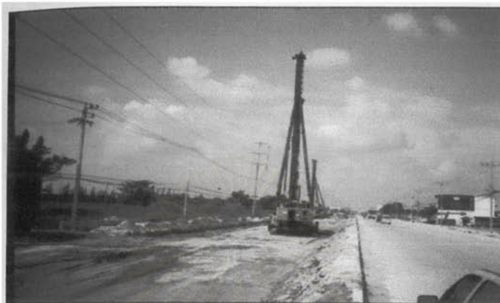
รูปที่ 3-6 แสดงภาพการก่อสร้างเส้นทางวัดกิ่งแก้ว
