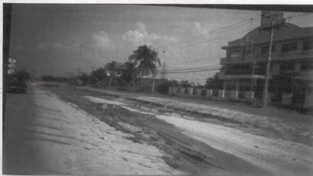
รูปที่ 3-7 สภาพถนนลาดกระบังขณะที่ทำการปรับปรุง
