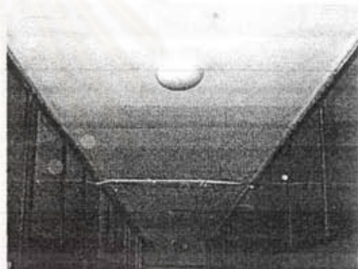
รูปที่ 4.20 ฝ้าชนิดฉาบเรียบ และ โคมชนิดขาว-ขุ่น
