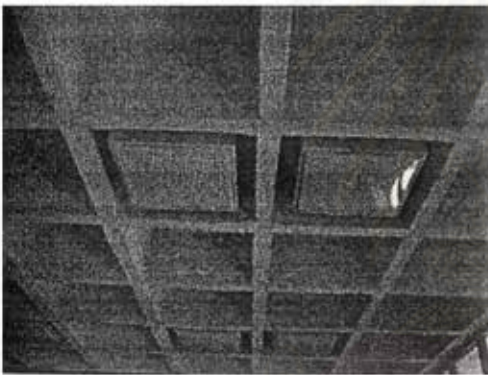
รูปที่ 4.19 ฝ้าชนิดวางฝัง และ โคมชนิดขาว-ขุ่น
