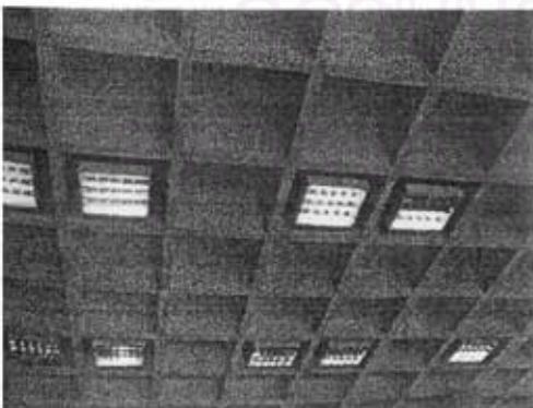
รูปที่ 4.21 โคมชนิดสะท้อนแสงในส่วนห้องสมุดชั้นล่าง
