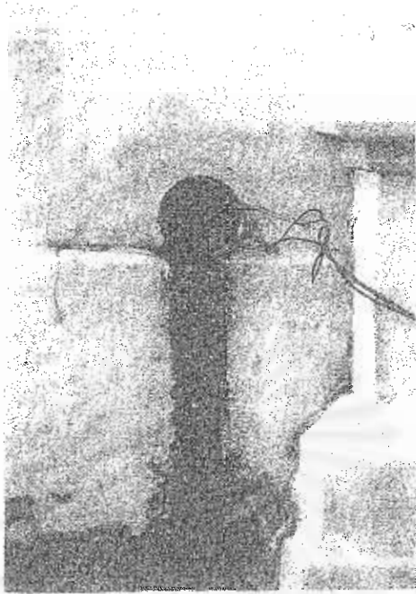
รูปที่ 4-159 ระบายน้ำจากกระเบื้องที่อุดตันและไม่มีประสิทธิภาพ
