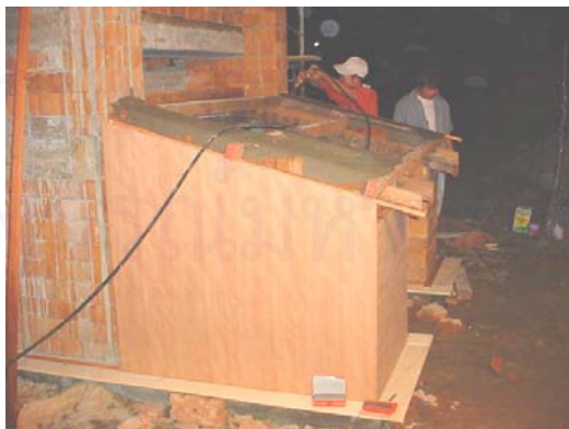
ภาพที่ 5.9 แสดงการก่อสร้างผนังส่วนช่องว่าง อากาศความหนา 5 เซนติเมตร
