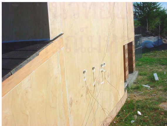
ภาพที่ 5.15 แสดงการติดตั้ง Sensor เพื่อทำการวัดผล
