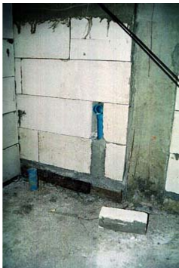
ภาพที่ 5-20 การฝังท่องานระบบในผนังคอนกรีตมวลเบา
