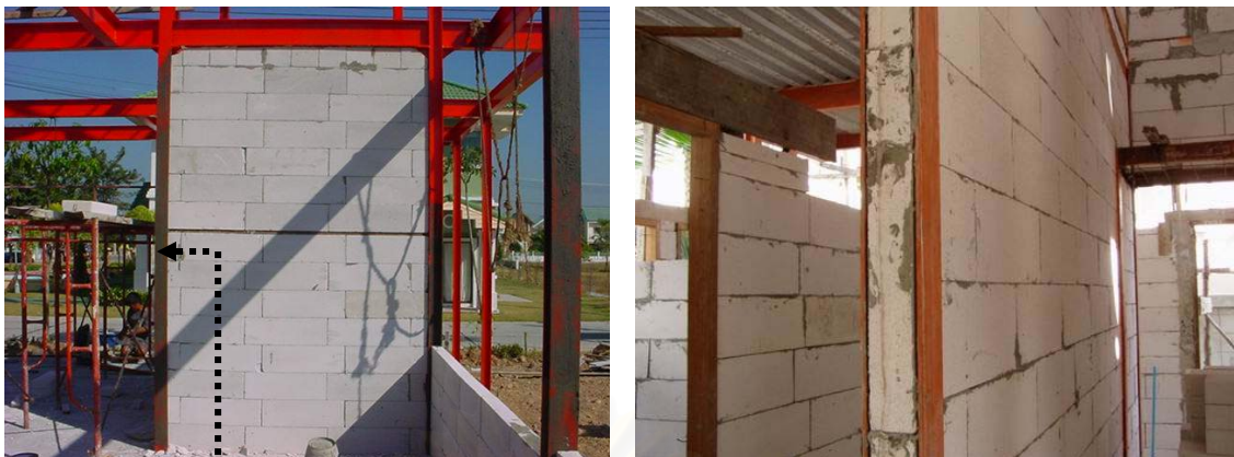
ภาพที่ 5-15 แสดงการก่อบล็อกคอนกรีตมวลเบายึดกับเสาเหล็ก H-Beam
