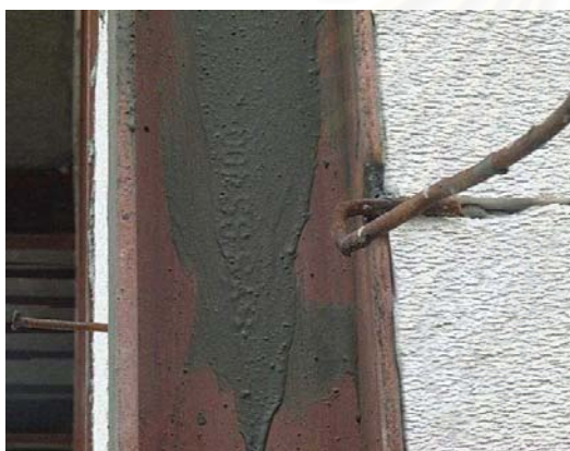
ภาพที่ 5-25 การทำปูนก่อที่ผสมน้ำยาเคมี ประสาน เข้ากับเสาเหล็ก H-Beam
