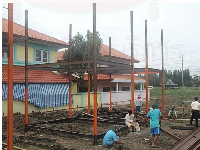
ภาพที่ 5-7 แสดงขั้นตอนการติดตั้งคานเหล็กชั้นบน
