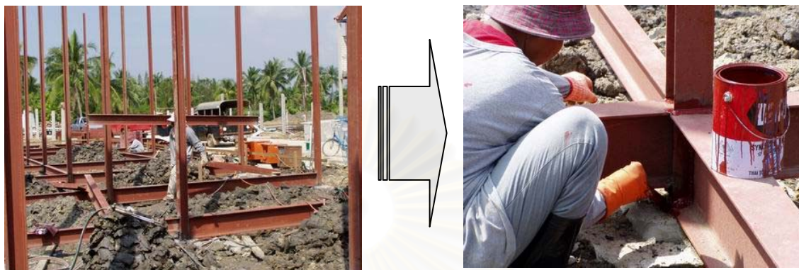
ภาพที่ 5-6 แสดงขั้นตอนการทาสีกันสนิมสำหรับโครงสร้างเสาเหล็ก และคานพื้นชั้นล่าง
