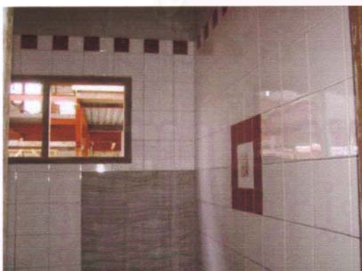
ภาพที่ 5-22 แสดงงานปูกระเบื้องผนังห้องน้ำ
