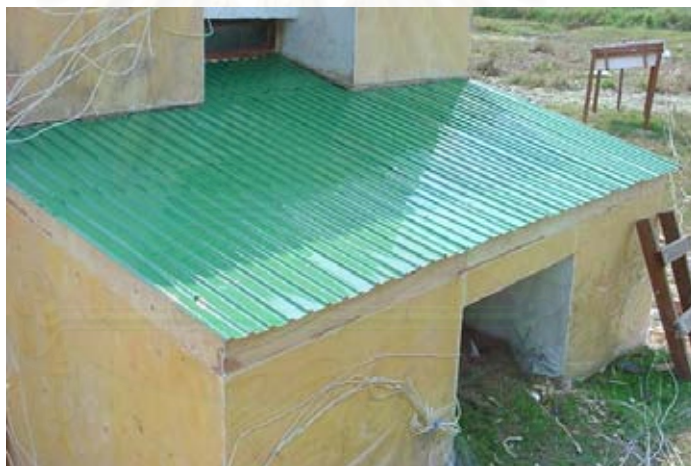
ภาพที่ 5-8 แสดงการเปลี่ยนวัสดุผนังหลังคาอาคารทดลองเป็นหลังคาสังกะสี
