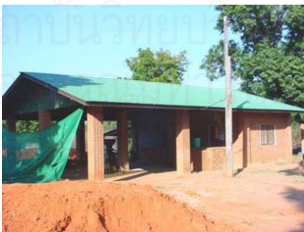
ภาพที่ 4-13 แสดงตัวอย่างอาคารที่ก่อสร้างด้วยอิฐดินซีเมนต์
