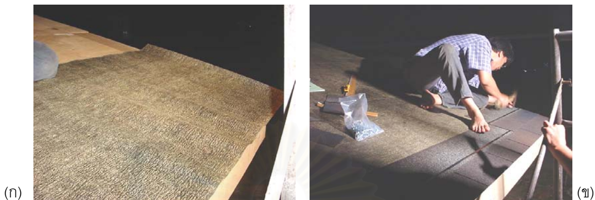
ภาพที่ 4-59 (ก) แสดงการปูแผ่นยางกันซึมบนแผ่นไม้อัดก่อนมุงแผ่นหลังคา Asphalt Shingle (ข) แสดงการมุงแผ่นหลังคา Asphalt Shingle ทับลงบนแผ่นยางกันซึม
