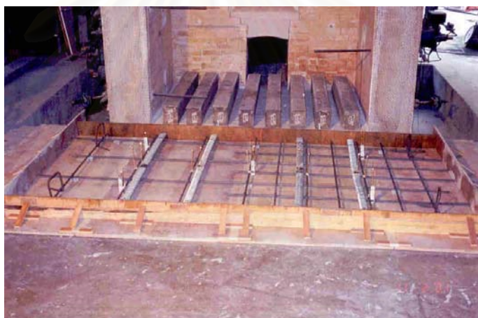
รูปที่ 3.8 แบบหล่อคอนกรีตสำหรับแผ่นพื้นที่ 1 (ลระยะห่างเหล็กเสริม)
