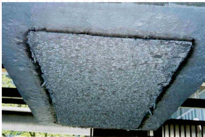
รูปที่ 3.78 การหลุดร่อนหลังการทดสอบความสามารถทนไฟ ของแผ่นพื้นที่ 4 (ทาสีทนไฟที่ผิวล่าง)
