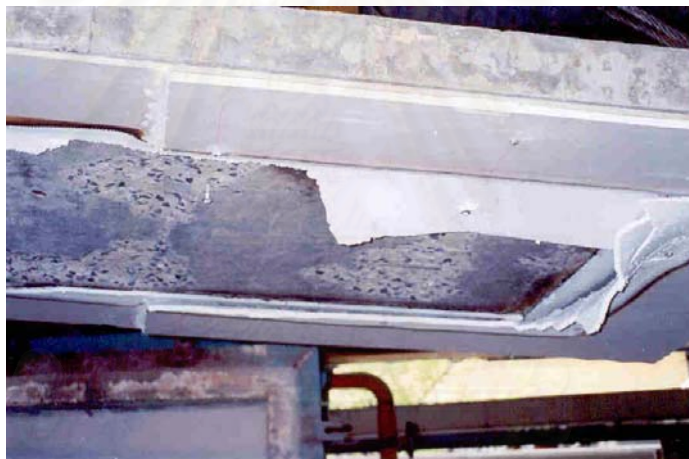
รูปที่ 3.77 การหลุดร่อนหลังการทดสอบความสามารถทนไฟ ของแผ่นพื้นที่ 3 (ติดแผ่นยิปซัมที่ผิวล่าง)
