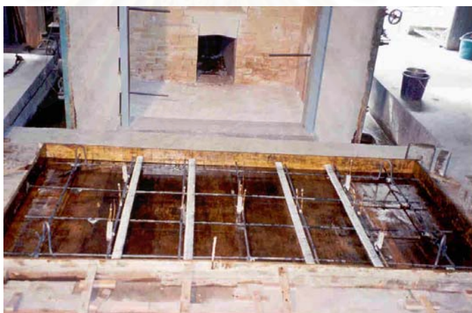
รูปที่ 3.14 แบบหล่อคอนกรีตสำหรับแผ่นพื้นที่ 3 (ติดแผ่นยิปซัมที่ผิวล่างของแผ่นพื้นที่)
