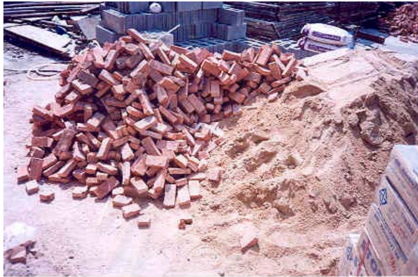
รูปที่ 4.4 การกองอิฐมอดูอย่างไม่เป็นระเบียบและใกล้กับวัสดุอื่นๆ ทำให้วัสดุเสียหาย
