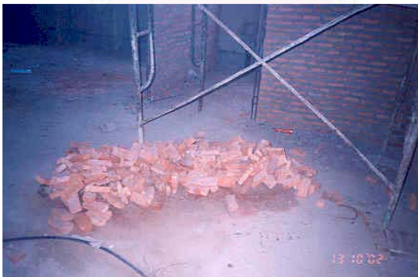
รูปที่ 4.6 อิฐมอดูที่เหลือจากการใช้งาน ไม่ได้เก็บให้ถูกวิธี ทำให้เกิดความเสียหาย
