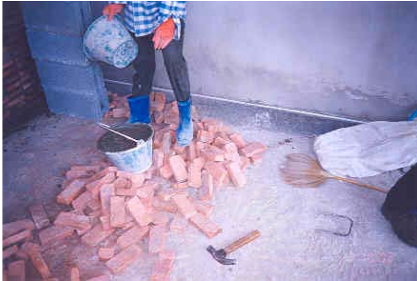
รูปที่ 4.5 การทำงานที่ไม่ถูกต้อง ขาดความระมัดระวังของคนงานในการทำงาน
