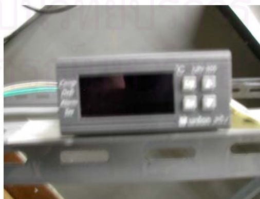
รูปที่ 3.4 เครื่องควบคุมอุณหภูมิของน้ำเย็น
