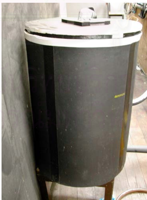
รูปที่ 3.2 ถังเก็บน้ำเย็น
