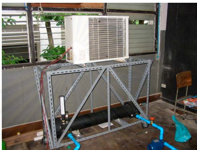
รูปที่ 3.3 เครื่องทำน้ำเย็น
