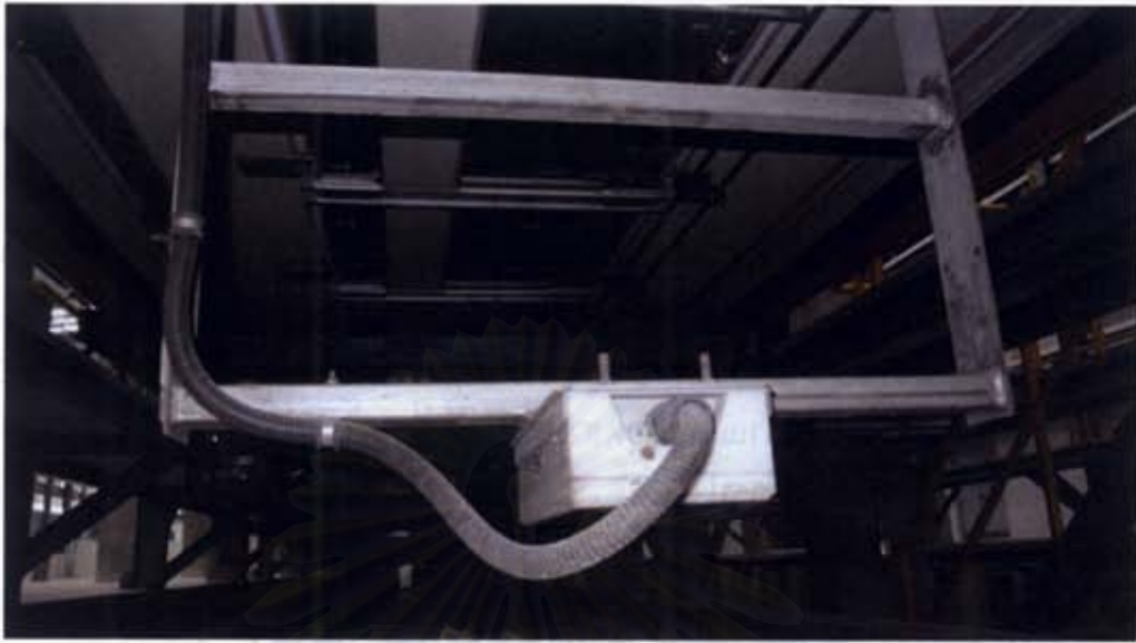
รูปที่ 5.19: อุปกรณ์ส่งสัญญาณสำหรับระบบอาณัติสัญญาณ
