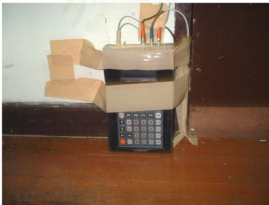
รูปที่ 7.15 มาตรวัดการไหลแบบอัลตราโซนิกที่ติดตั้งอยู่ในห้องควบคุม
