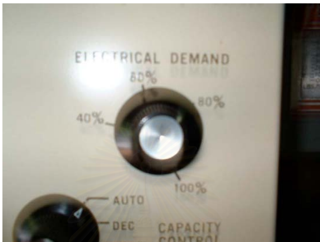
รูปที่ 7.4 ตู้ควบคุมที่ใช้สำหรับการปรับโหลดไฟฟ้า
