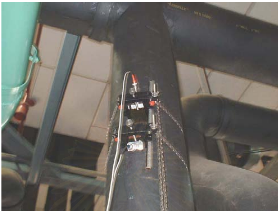
รูปที่ 7.14 การติดตั้งหัววัดของมาตรอัตราการไหลแบบอัลตราโซนิก
