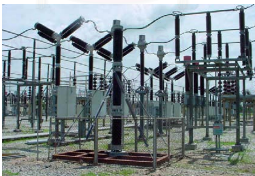
รูปที่ 4.25 โวลเตจดีไวเดอร์ที่ติดตั้งในระบบสายส่ง 230 kV
