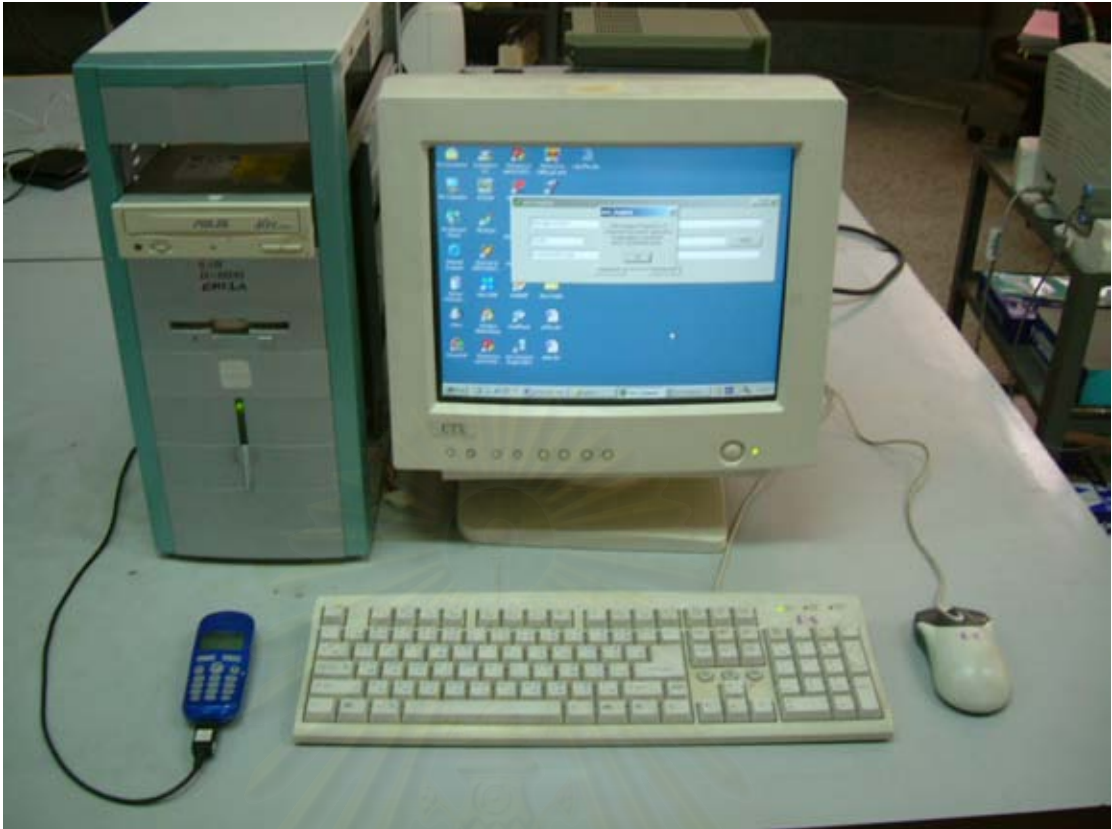
รูปที่ 7.6 Alarm Control Unit ของระบบ
