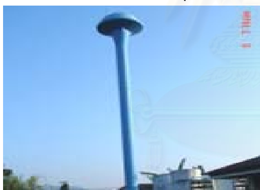
รูปที่ ก ประปาชุมชน
