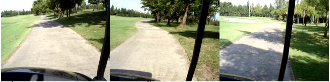
รูปที่ ค-42 แสดงลักษณะถนนในช่วงระยะตั้งแต่ 800 – 1100 เมตร ของสนามกอล์ฟ บางกอกกอล์ฟคลับ หลุม 1-9
