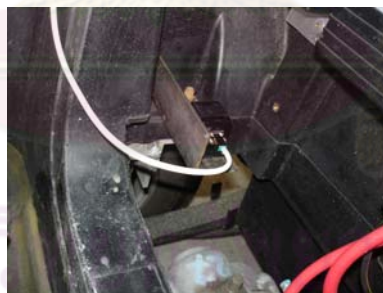
รูปที่ 4-7 ตำแหน่งการติดตั้ง Accelerometer
