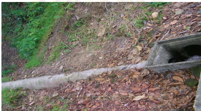
ภาพที่ 4.11 แนวคูน้ำเวียงเจ็ดลิน เมื่อได้รับน้ำแล้วมีการระบายน้ำลงสู่คูเมืองโดยรอบก่อนที่จะระบายไปยังอ่างแก้ว
