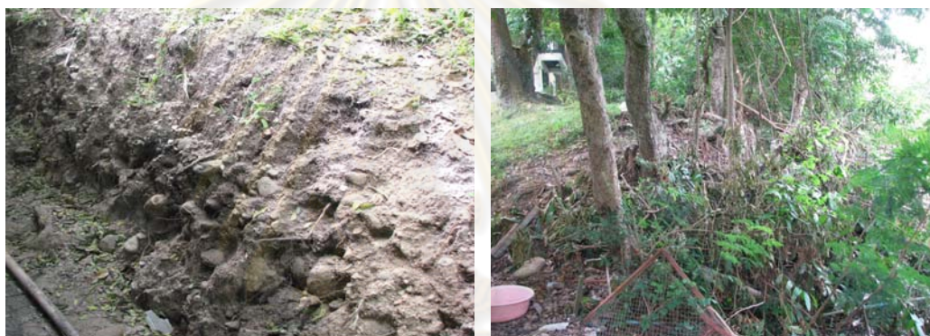
ภาพที่ 4.21 แนวคันดินทางด้านทิศตะวันตกเฉียงใต้บริเวณใกล้อ่างเก็บน้ำอ่างแก้วที่สามารถเห็นได้ชัดเจนมีสภาพเสื่อมโทรมขาดการพัฒนาพื้นที่คูน้ำ - คันดินบริเวณนี้ให้สวยงาม
