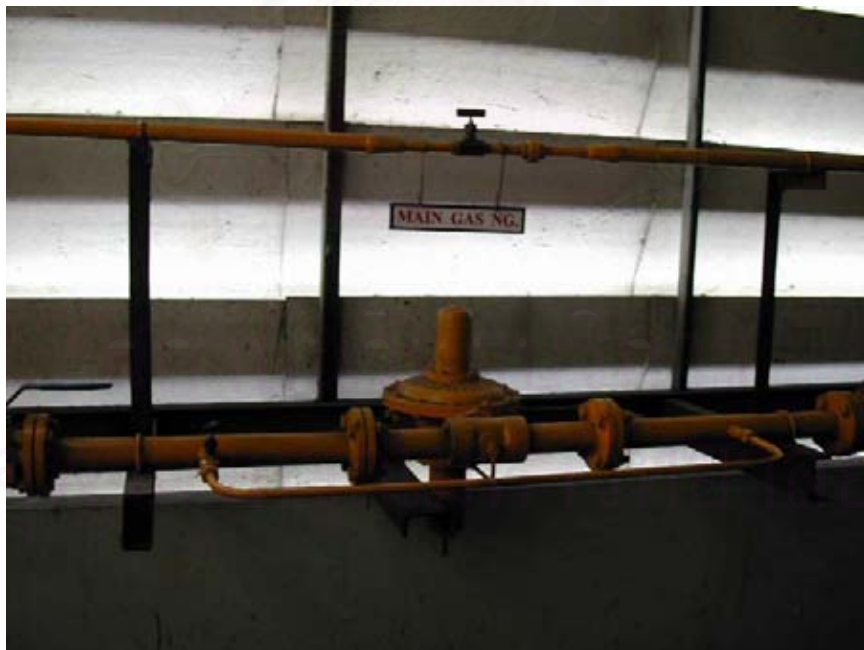
รูปที่ 6.8 อุปกรณ์ปรับความดันก๊าซบริเวณทางเข้าโรงงานหลอมทองแดง
