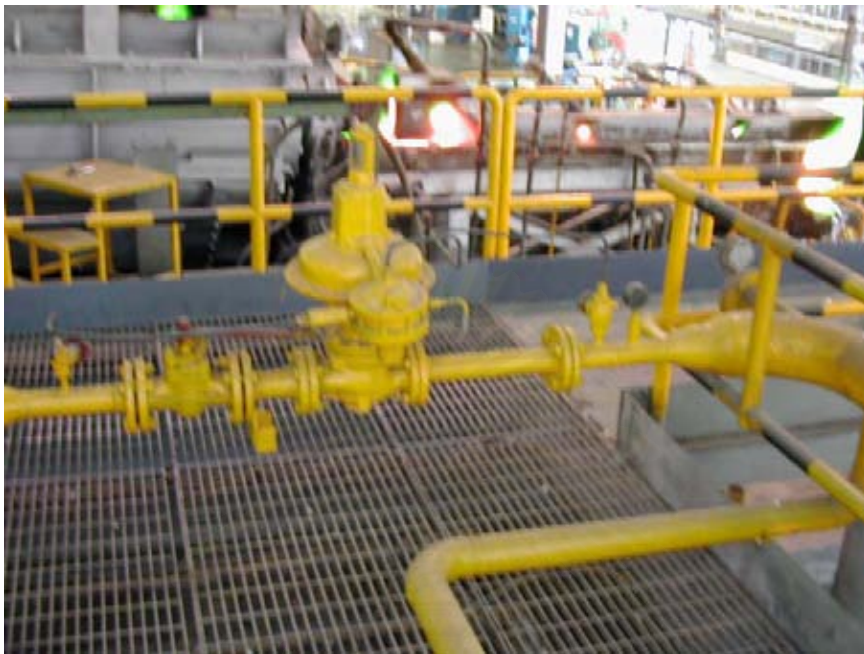
รูปที่ 6.9 อุปกรณ์ปรับความดันก๊าซก่อนเข้า Zone Regulator
