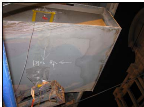
รูปที่ 5.7 ภาพขยายการติดตั้งอุปกรณ์ตรวจจับสัญญาณที่ปลายคานขวาง
